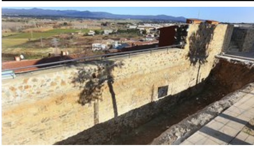
Les obres a la muralla de Llagostera per fer-hi el mur soterrat de contenció Foto: MANEL LLADÓ.
