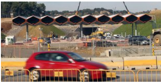
Les obres de l'enllaç de Sant Gregori, fa pocs dies. Foto: JORDI RIBOT / ICONNA.
