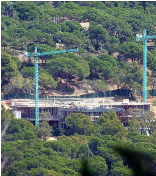
Imatge dels primers moments de les obres a la casa dels masovers de Can Juncadella el 2010. Foto: ELPUNTAUVUI.
