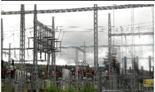
Central de distribució elèctrica situada sota del barri del Morrot, a la perifèria d'Olot.
