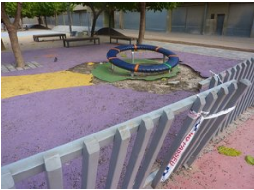
Detall d'una tanca i del paviment sintètic fets malbé, la setmana passada. Foto: R. E.
