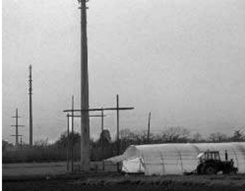
Las torres están instaladas en Llagostera, pero aún falta el cableado
