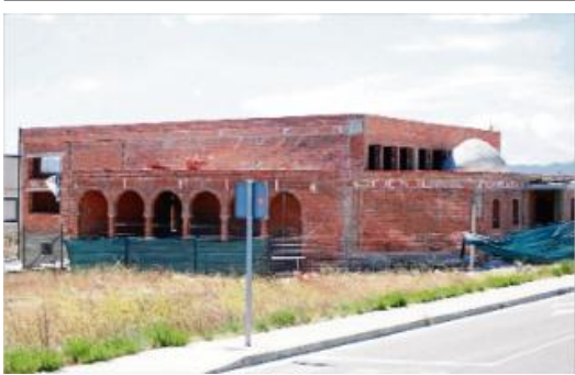
Imatge de l'estat actual de les obres de construcció de la mesquita que s'ubica al polígon de Torroella.
