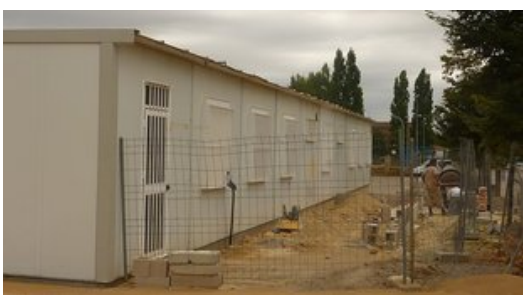
Aspecte de les instal·lacions, en una imatge de dimarts. Foto: R. E.
