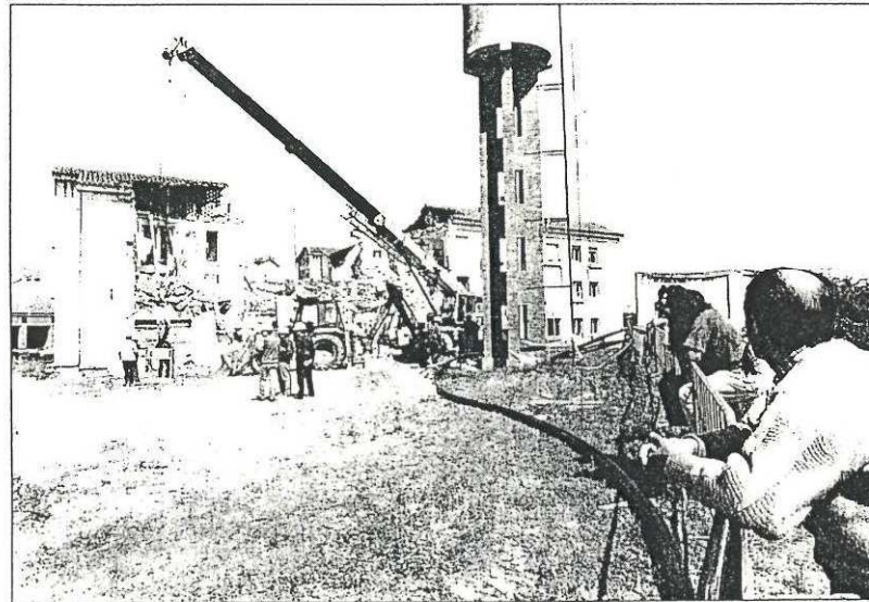
Imatge del bloc, en el moment en què s'enderrocava la part més afectada.
