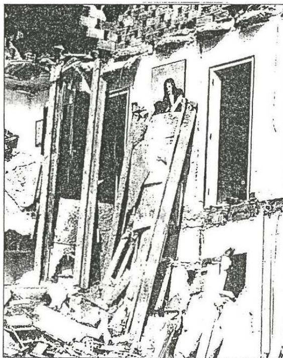
Aspecto de una vivienda del inmueble hundido a causa de la explosión.
