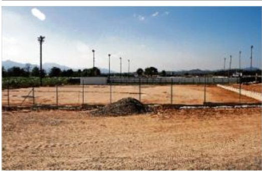
Imatge d'aquesta setmana de les obres de construcció dels dos camps de futbol 7 a Vilobí d'Onyar.
