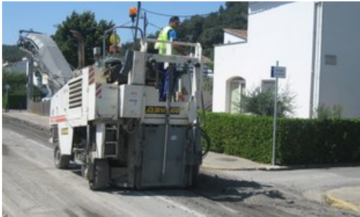
Una màquina asfalta el carrer d'en Xucla, a Sarrià de Dalt, dijous al matí, dins els treballs de la zona afectada per les infraestructures Foto: J.F.
