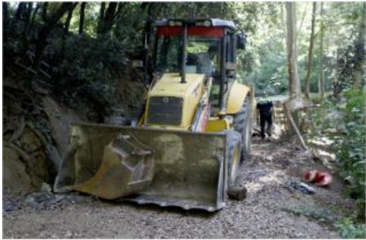
L'excavadora treballant en la parcel·la boscosa de la Joia del Montseny d' Arbúcies on hi havia els cans.
