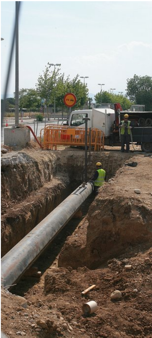
Obres que s'estaven fent ahir a la tarda a la sortida de l'AP-7 a Sant Gregori. Foto: MANEL LLADÓ.
