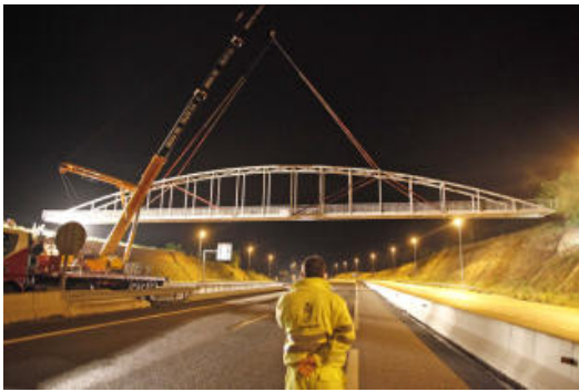
A dos quarts de dues de la nit, la grua va col·locar el pont, de 49 tones.
