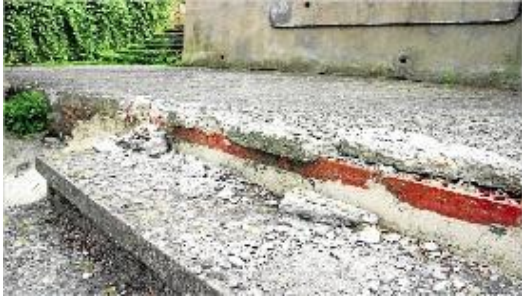
Estat en què van quedar alguns esglaons per on va passar el cotxe
