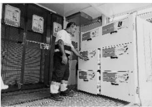
Fornells Nou dipòsit per a l'oli al servei de recollida
