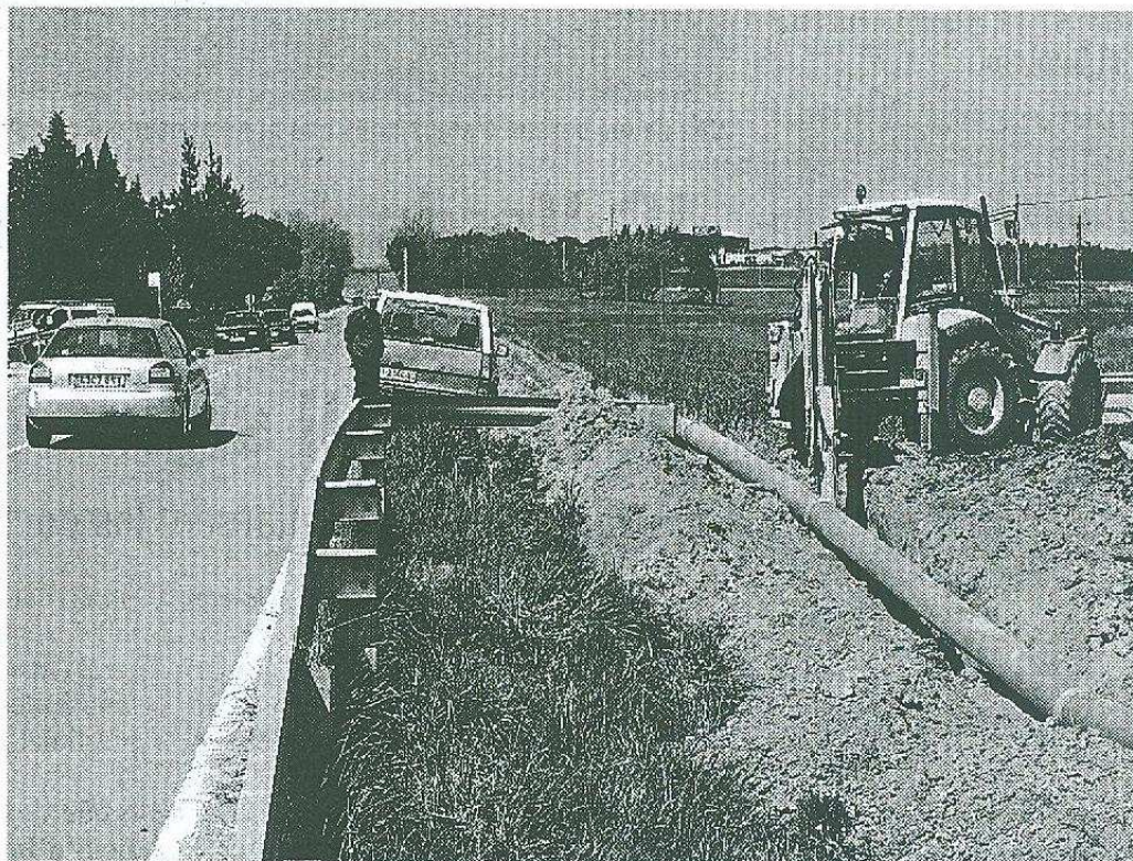
Les obres de la canonada que connectarà el pou amb els dipòsits. / ANNA PUIG.
