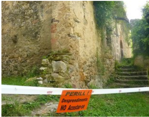
L'antiga rectoria. Un cartell avisa de la perillositat de l'edifici. Foto: R. E..
