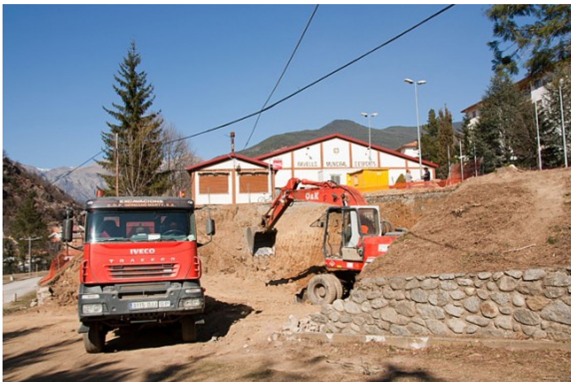
Obres per instal·lar la caldera de la xarxa de calor de Ribes. Foto: Laia Deler
