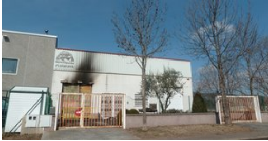
Una vista de l'exterior de la fàbrica del polígon del Pla de Baix, afectada greument pel foc. Foto: J.C.
