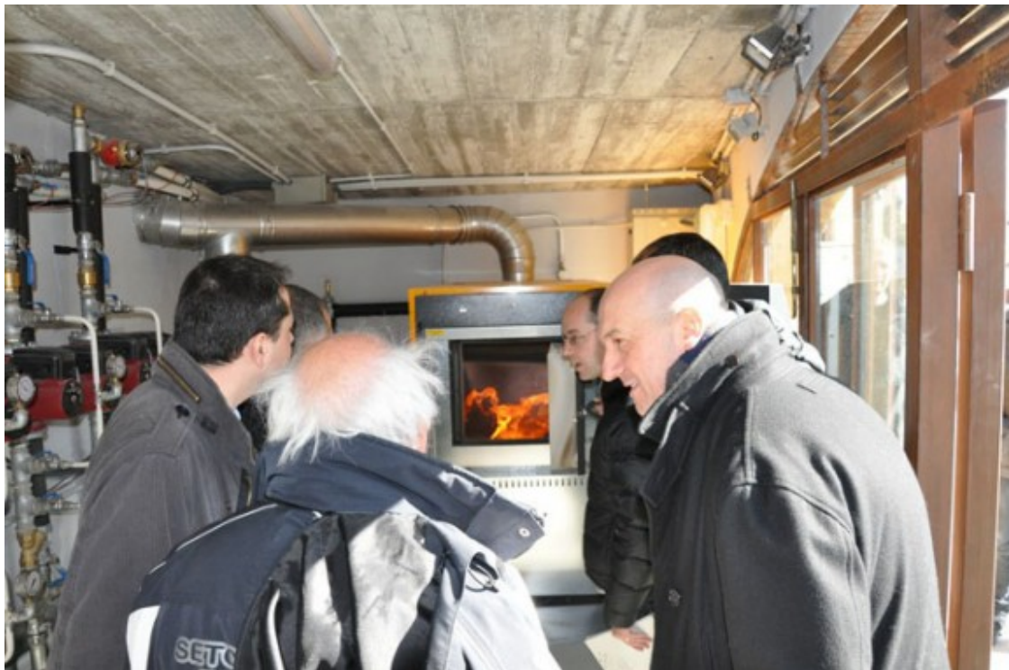
Visita a la caldera de biomassa de Llanars. Foto: CCR
