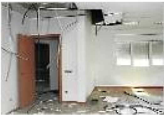
Destrosses a la depuradora. <br/>
