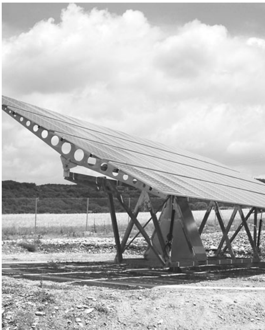
Una de les instal·lacions d'una granja solar a Aragó. / WATTPIC
