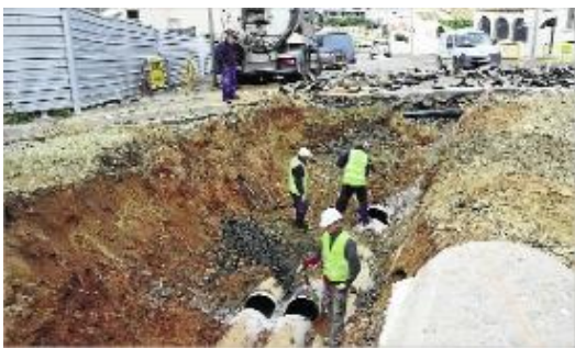
Els operaris intentant reparar la fuga a l'accés al port. <br/>
