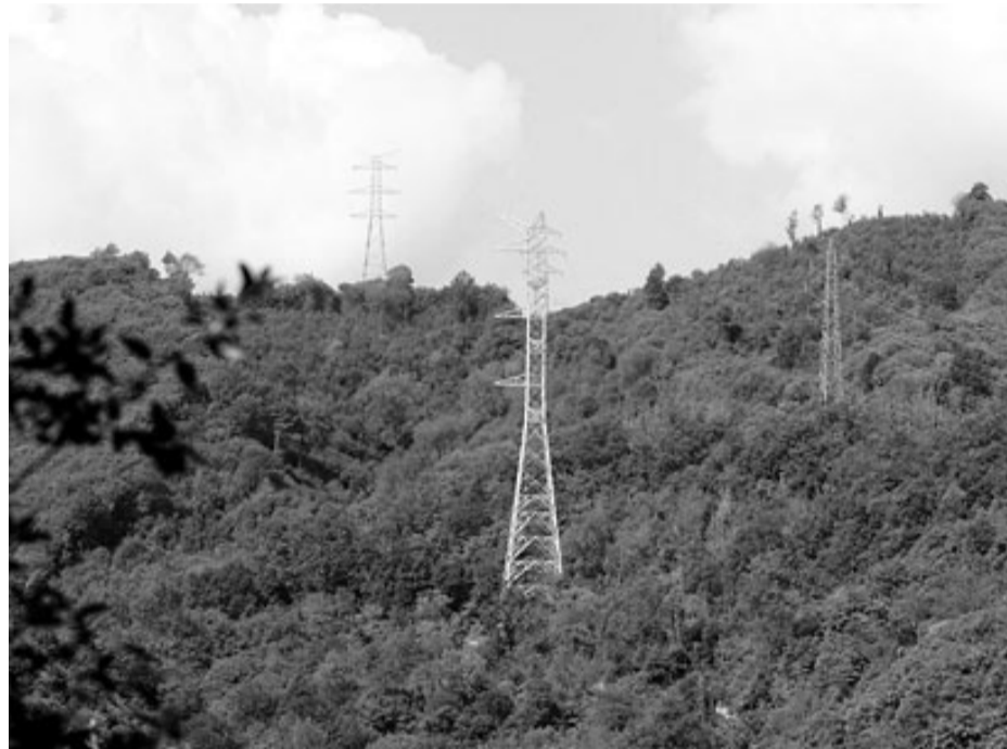
Torres de la línia de 400.000 volts a Osor, en una imatge d'arxiu. / EUDALD PICAS
