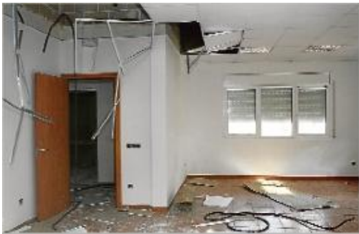
Estat en què va quedar una de les habitacions de la planta.
