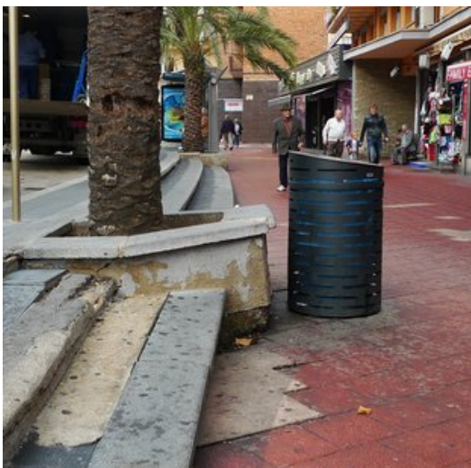
Les voreres de l'Avinguda Just Marls, que estan molt deteriorades. Foto: N. FORNS.
