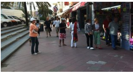
L'enrajolat, voreres i graons de l'Avinguda Just Marlès estan en molt mal estat. Foto: N. FORNS.
