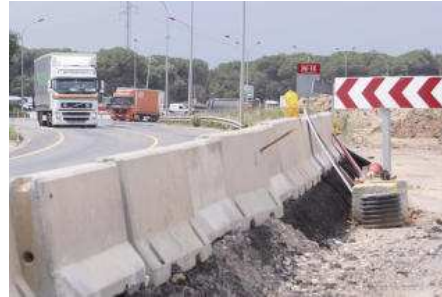
Les obres del desdoblament de la N-II al seu pas per Caldes de Malavella estan aturades des de fa temps a l'espera del Ministeri de Foment. arxiu/diari de girona
