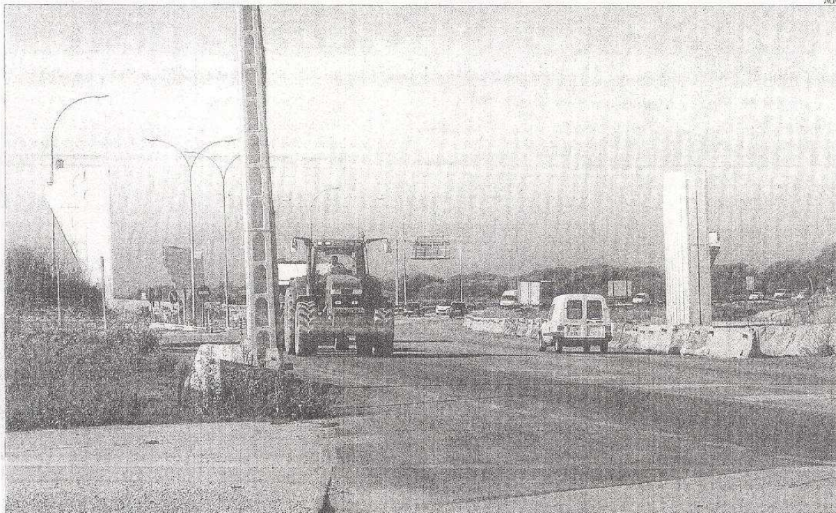
L'estat actual de la N-II, amb les obres aturades des de juny de 2009, és amb estructures a mig fer i les línies grogues provisionals.
