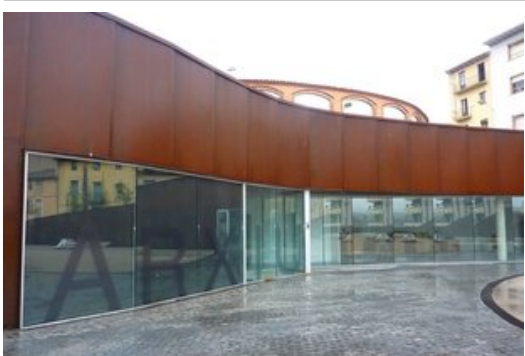
Exterior del nou arxiu la part del complex del Torín més afectada per defectes constructius. Foto: R. E.
