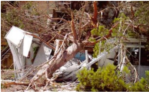
El pi aixafant les instal·lacions del Club Nàutic Cala Canyelles i el bar Foto: EL PUNT.
