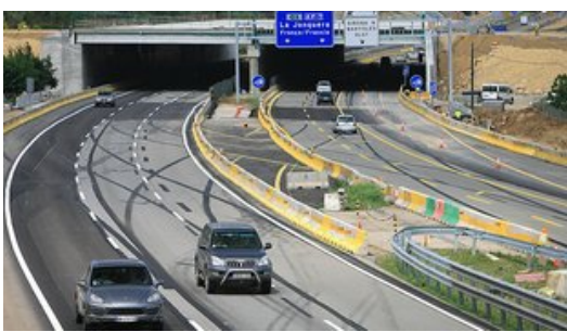
Les obres de l'autopista, ahir a l'alçada de Sant Julià de Ramis, amb els tres carrils ja acabats en direcció sud. Foto: MANEL LLADÓ.
