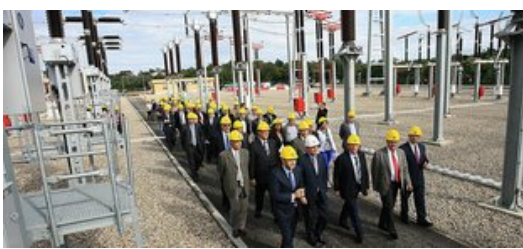
Les autoritats ahir a la tarda passejant per l'interior de la subestació de Bescanó. Foto: MANEL LLADÓ.
