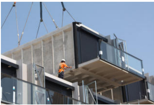
El procés de construcció dels pisos de protecció del carrer Orfes. <br/>
