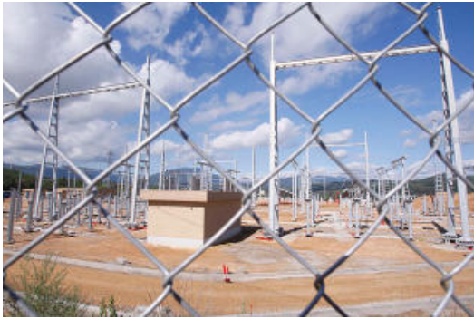
La subestació de Red Eléctrica a Bescanó, en una imatge d'arxiu.
