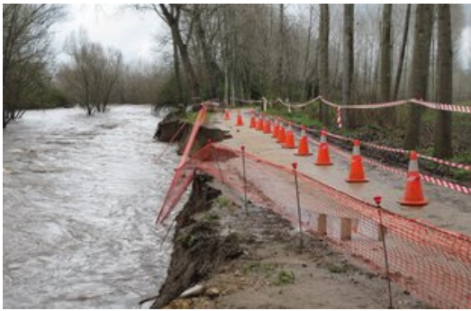
Efectes de la crescuda del Ter a la Pilastra Foto: J.N.
