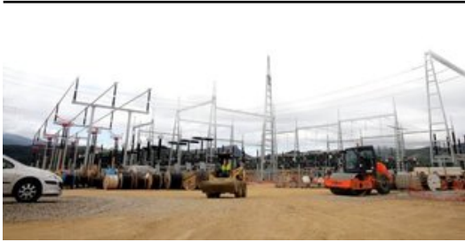
La subestació de la MAT a Bescanó, en obres, en una imatge d'arxiu de l'octubre passat. Foto: JULIETA SOLER.
