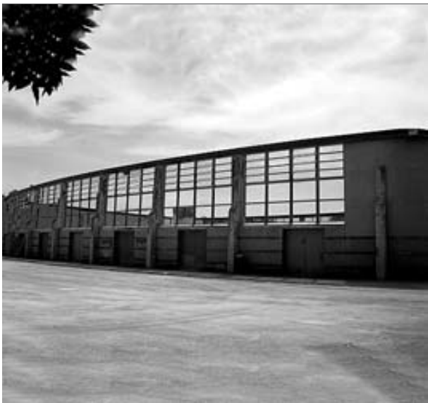
El pavelló de Quart un cop retirat el sostre esfondrat durant la nevada del 8 de març ■ J.N.
