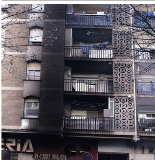
Imatge de la façana del carrer Àngel Guimerà de Salt afectada pels aldarulls de la setmana passada Foto: LLUÍS SERRAT.
