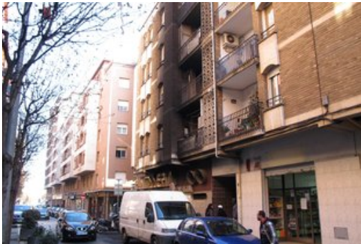
La façana d'un edifici afectada per l'incendi d'un vehicle. Foto: JORDI NADAL.
