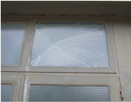
Un vidre trencat. Foto: EL PUNT.
