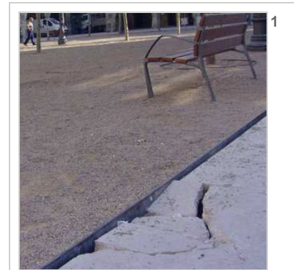
Blocs trencats. Imatge d'arxiu d'unes peces trencades del paviment de la plaça Major, a causa del pes dels vehicles de més tonatge. Foto: R.E.
