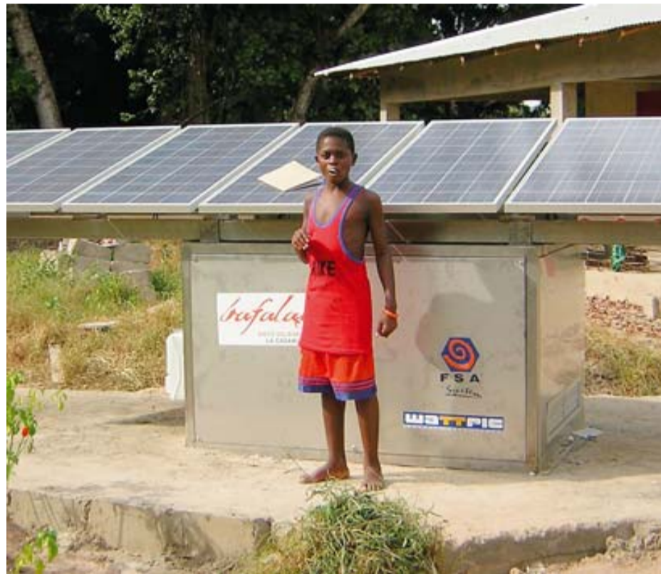
Projecte per instal·lar energia solar a Casamance (Senegal), de l'ONG Bafalay, amb la col·laboració de l'empresa Wattpic Energia Intel·ligent.
