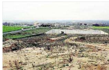
Les obres del tram des de Maçanet fins a Sils es troben empantanegades des de fa més d'un any. carles colomer
