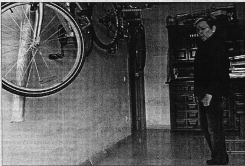
AFFECTADA. Francesca Juanola mostra l'estat de les parets que han sofert els efectes de les darreres inundacions.
