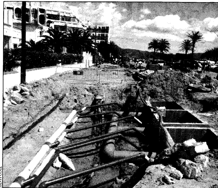
Els operaris treballen per poder acabar les obres del front marítim aquest juny
