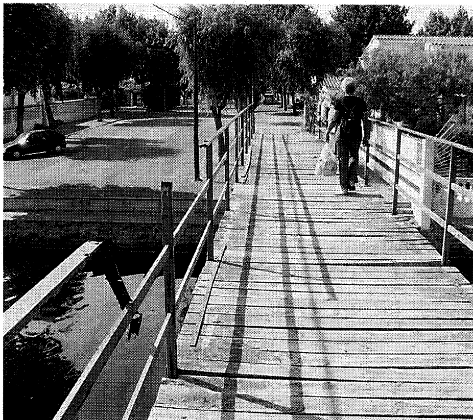
Un dels ponts de vianants, amb la barana trencada i rovellada. / ROBERT CARMONA.
