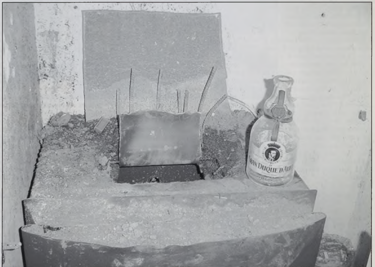
Caixa forta forçada
